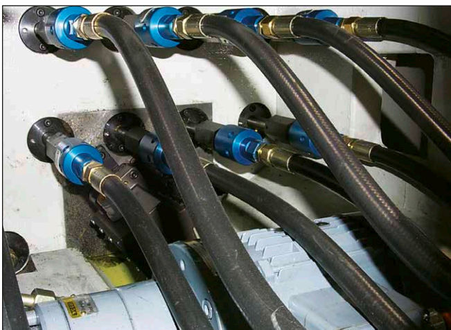
Deublin 1116 Drehdurchführung mit eigener Lagerung an Transferstraße
