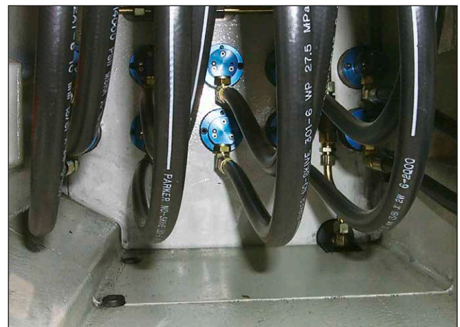
Deublin 1117 lagerlose Drehdurchführung an Transferstraße
