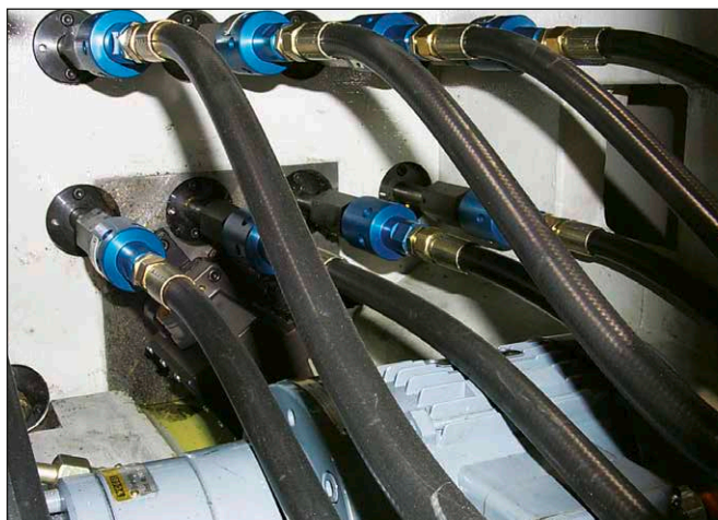
Juntas com suporte de rolamento Deublin 1116 na linha de transferência automotiva.
